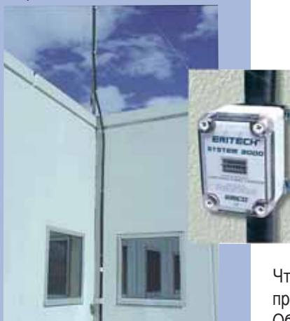
Вертикальный молниеотвод ERITECH ERICORE легко приспособляется к существующим конструкциям. На вставке: счетчик ударов молнии ERITECH® (LEC IV), установленный для регистрации грозовых разрядов на систему ERITECH® SYSTEM 3000.
